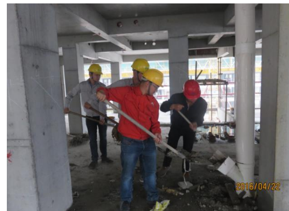
楼栋内竖向垃圾通道
